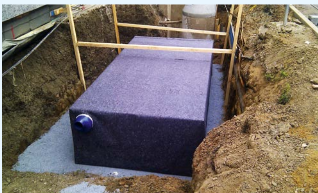
Haycint Modřany, bytové domy Retenční nádrže – 5 objektů o celkovém objemu 85 m 3 (použity byly systémy Azura, Q-Bic, Q-BB, regulace odtoku) Developer: YIT
