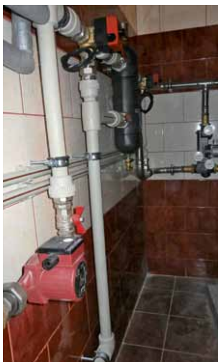
Obr 4: Ukázka rozvodu vícevrstvé trubky
